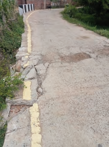
टूटी पड़ी नवनिर्मित सड़क
